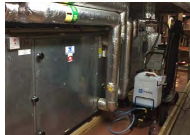
Utrustning för avgasning uppkopplad mot värmeåtervinningsystem.
