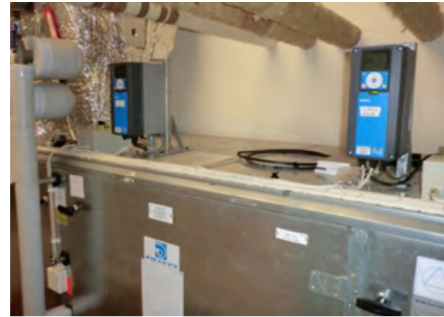
Ventilationsaggregat som kompletterats med frekvensomformare för tryckstyrning.
