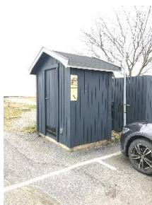
Reningsanläggning (F) och dieseltank bakom plank (G)
