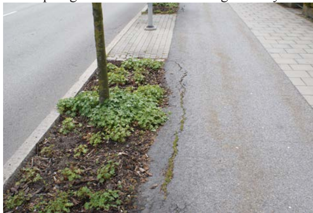
Kantskada på cykelvägen längs Kristianstadsvägen, Ystad
